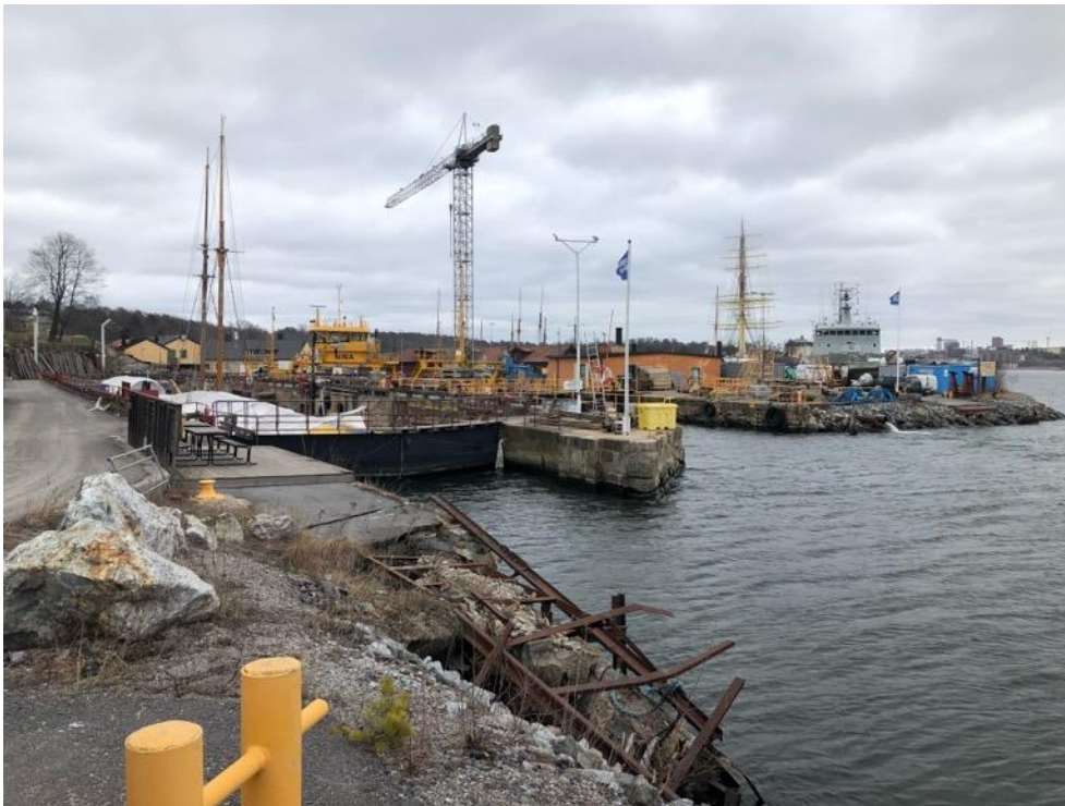
Figur 4-4. Rasade kajer på vid pumphus GV och nära östra dockan.
